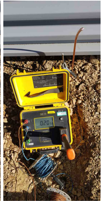
Terre électrique descente n°2
