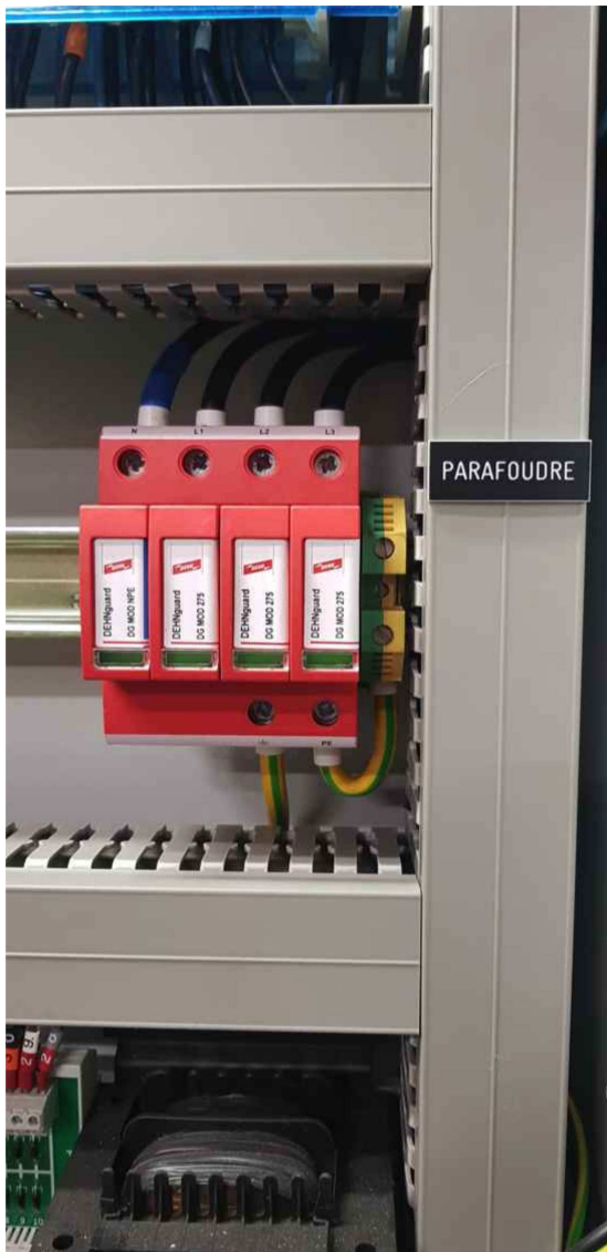
Parafoudre Local sprinkler – Vue de près
