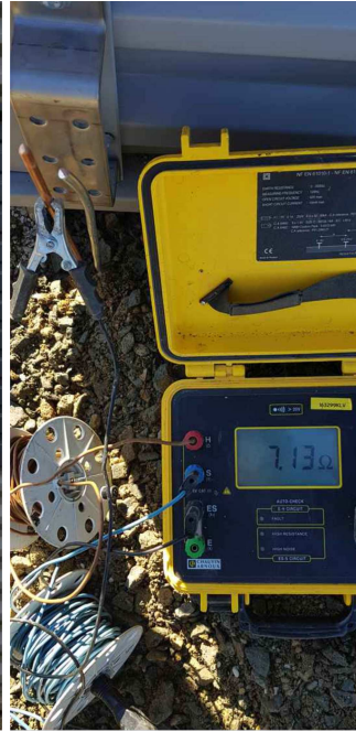
Terre paratonnerre descente n°1
