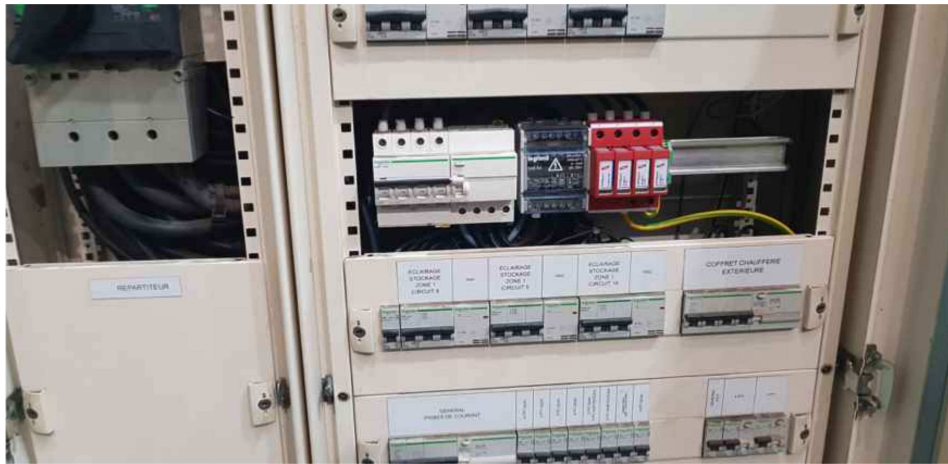
Parafoudre de Type 2 - cellule 2 – Vue d'ensemble
