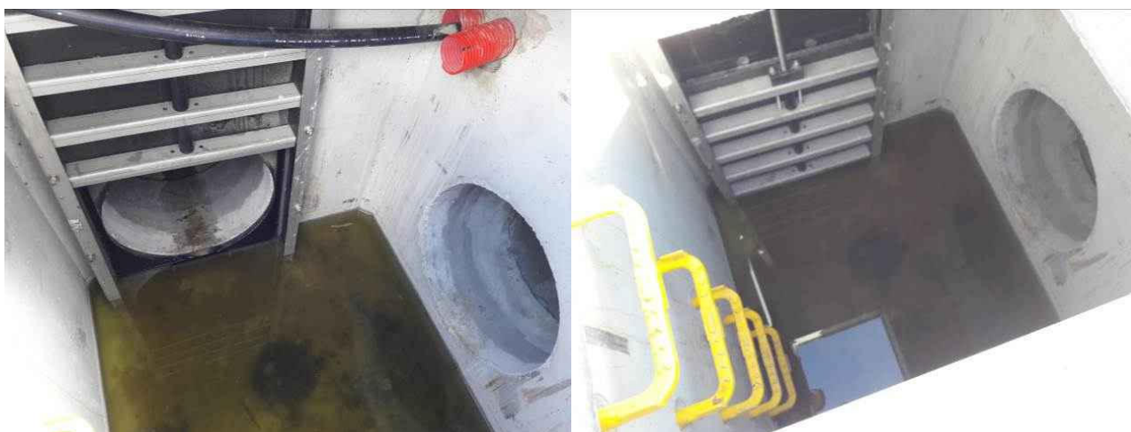
Vanne de confinement sortie bassin
