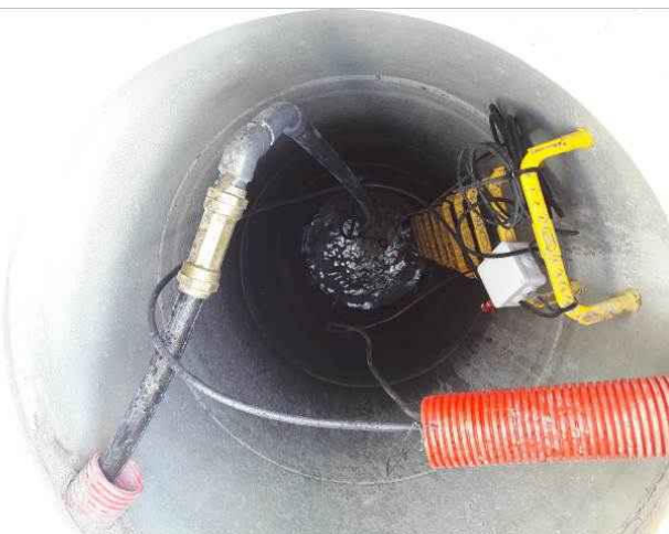
Pompes de relevage drainage et fond de bassin
