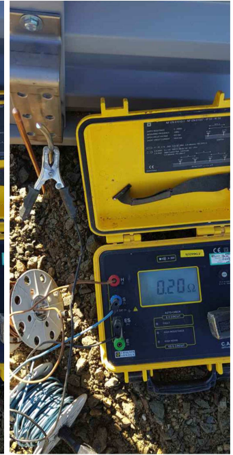
Terre électrique descente n°1
